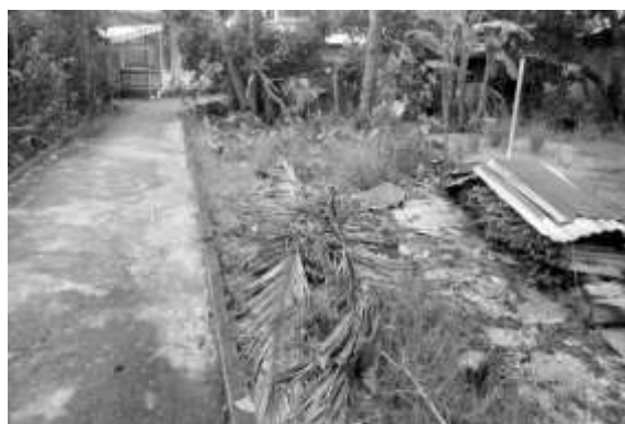
Gambar 2. Kondisi jalan di Desa Penjajab
