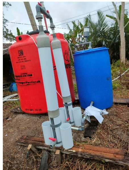
Gambar 7. Instalasi Penjernih Air Gambut
