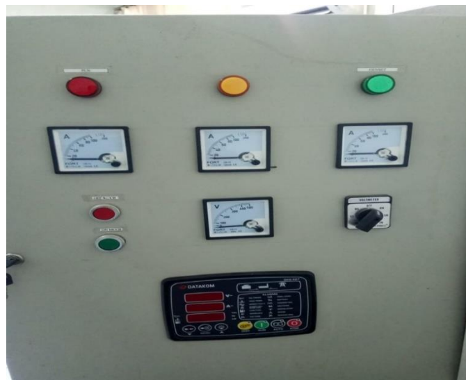
Gambar 6 Pintu panel AMF-ATS
