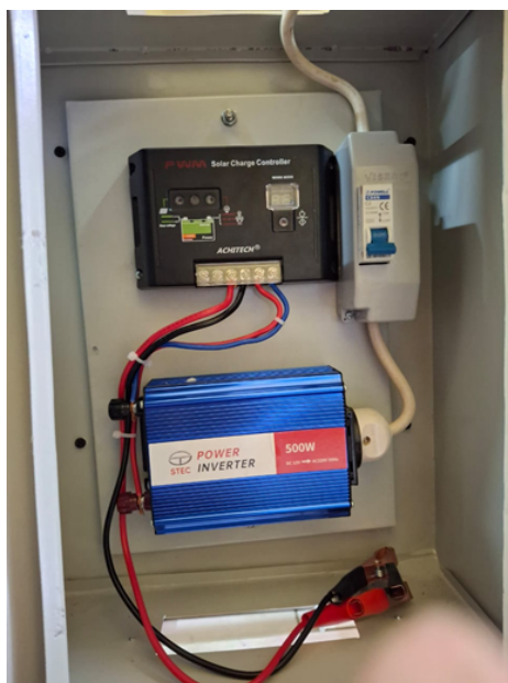
Gambar 3. SCC dan Inverter Pada PLTS
